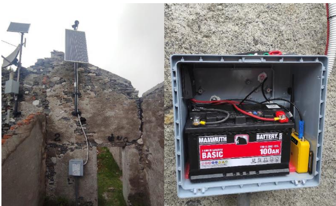
Figura 8 – Strumentazione installata a Casermette di Marta.
