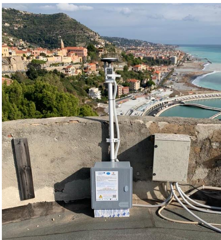
Figura 12 – Installazione GNSS presso il terrazzo sommitale di Forte Annunziata (Ventimiglia).
