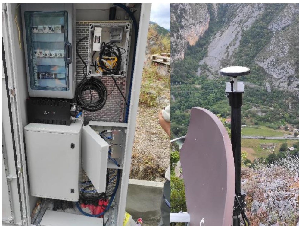
Figura 4 – Strumentazione installata in Saorge.
