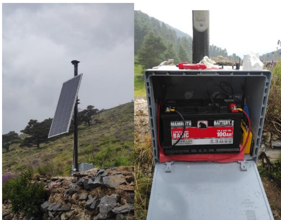
Figura 6 – Strumentazione installata a Bergerie d'Anan.
