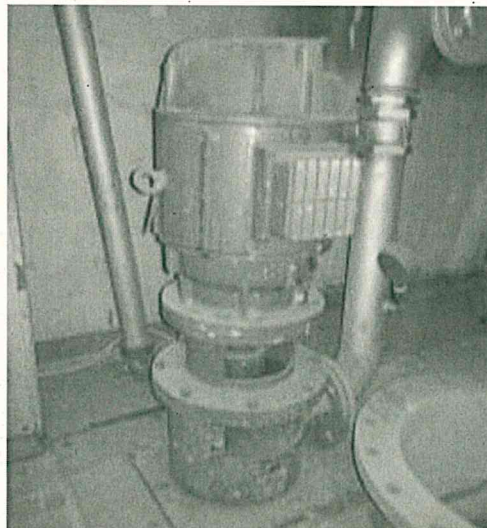
Foto n.12 – Pompa ad asse verticale
