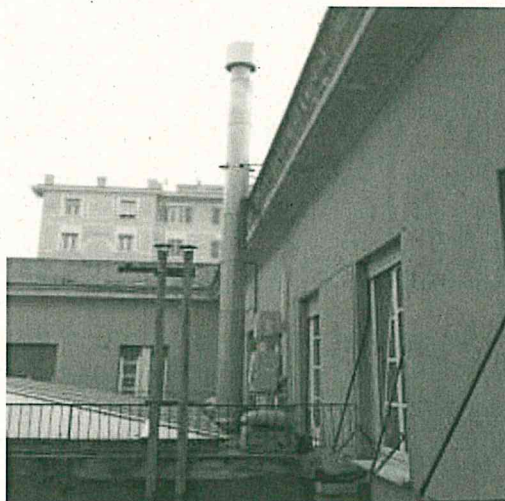
Foto n.6 - Camino in acciaio inox
